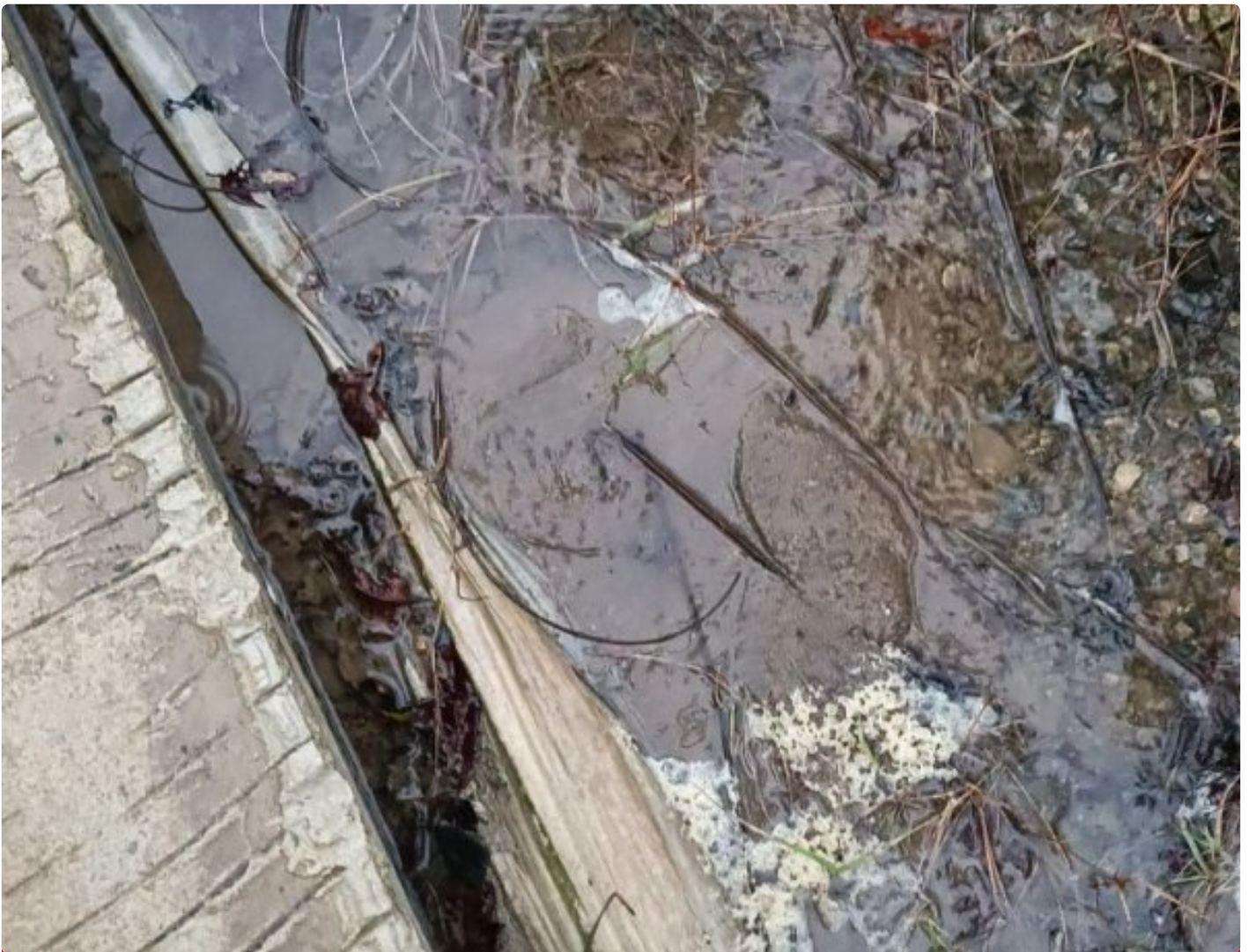
Kebocoran yang diduga pipa Perumda Air Minum Tirta Waesai kabupaten Barru di Jl. Petta Makka Parenring Desa Mattirowalie Kecamatan Tanete Riaja
